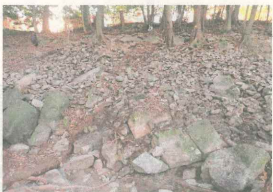
天主台東面の崩落状況（東から）
